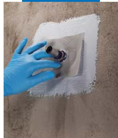
Aanbrengen van een Mapeband PE 120 afdichting voor doorlopende gaten met Mapegum WPS
